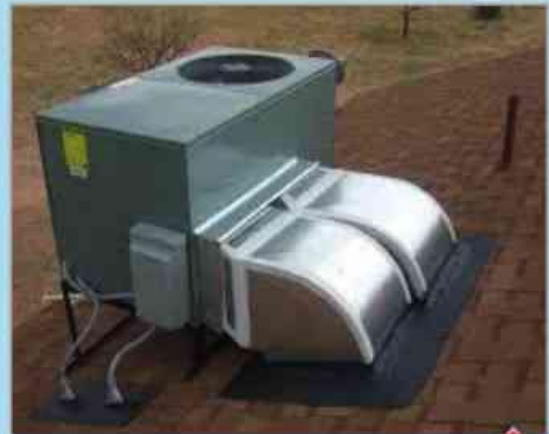
شکل ۱۵: واحد خارجی سیستم rooftop در حالت ورود کانال از سقف
