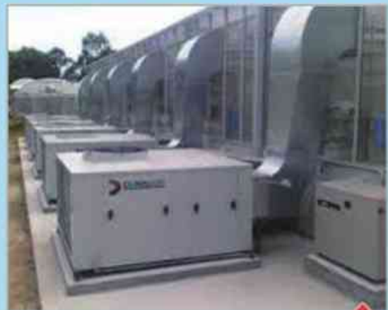
شکل ۱۶: واحد خارجی سیستم rooftop در حالت ورود کانال از دیوار
